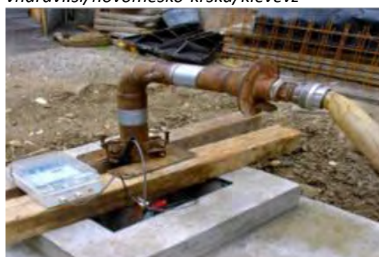
Vodnjak za podzemno vodo ( \approx 13 \text{ kW} na 1 \text{ l/s} dT=3^\circ\text{C} ) http://www.geo-hidro.si
